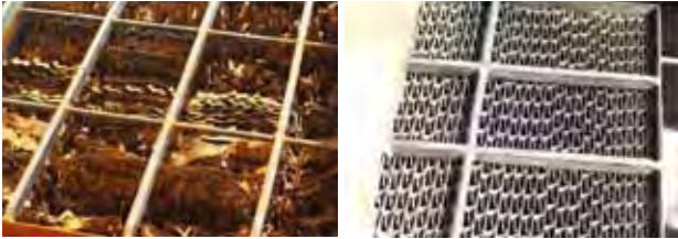
一般鋼の適用(腐食深刻)
