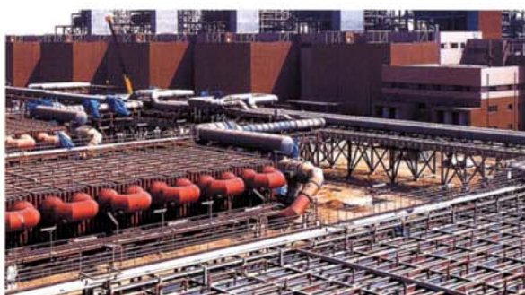
淡水化設備 (資料: DOOSAN重工業)
